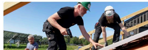
Grundläggande installatörsutbildning – Solceller
